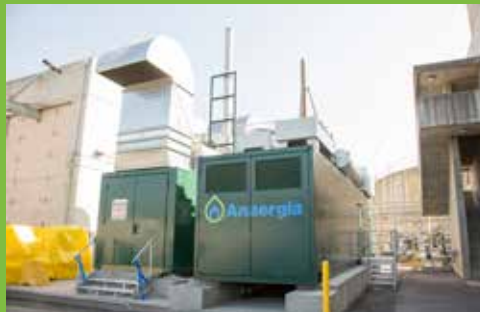
Escondido Hale Avenue Resource Recovery Facility (Escondido, CA)
